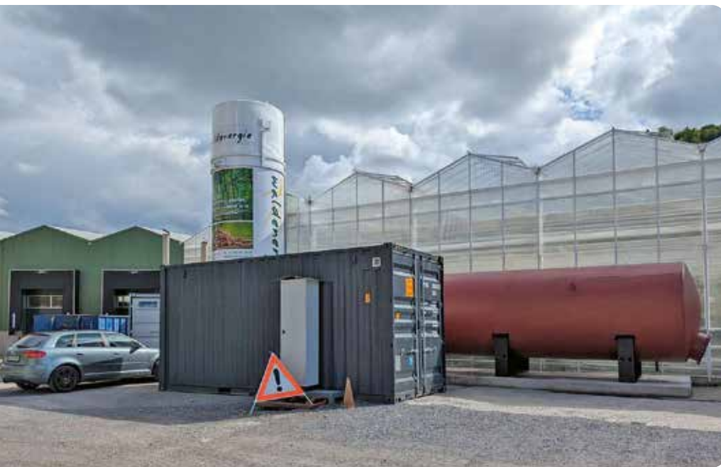
Die Abwärme von Servern wird für die Beheizung von Gewächshäusern genutzt.
